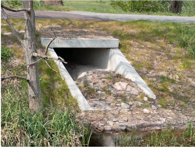
Abb. 6: Kleintiertunnel an der L22 aus U-förmigen Betonfertigteilen. Vor der Abdeckung ist der Einbau von Substrat und einer Berme für den Fall hoher Wasserstände möglich (Foto: Christin Hildebrandt).
