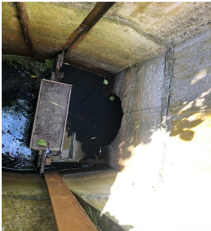
Abb. 8: DaMo 2 (14 SAW), Blick in den Kontrollschacht über dem Rohrdurchlass, Rohrdurchmesser ist 80 cm. Man sieht die „Kontrollschwelle“, über die querende Tiere wechseln müssen (Foto: Christin Hildebrandt).
