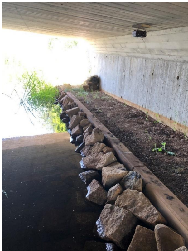
Abb. 9: Blick auf die (einseitige) Berme der Brücke Flö1. Beachte die Wildkameras an der Decke und im Hintergrund. Auf der Betonkante sind umfangreiche Otterlosungen zu erkennen (Foto: Christin Hildebrandt).
