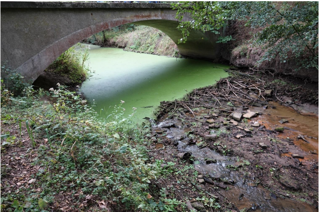
Abb. 4: Damm in Revier 2 an der Eyßelgehege-Brücke in Gifhorn (Foto: K. J. Borchert).
